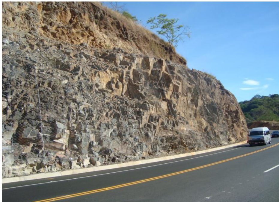
Macizo rocoso fracturado con un juego de discontinuidades con buzamiento favorable al volcamiento conjugado con otro juego de discontinuidades sub horizontal que promueve la caída de rocas.
