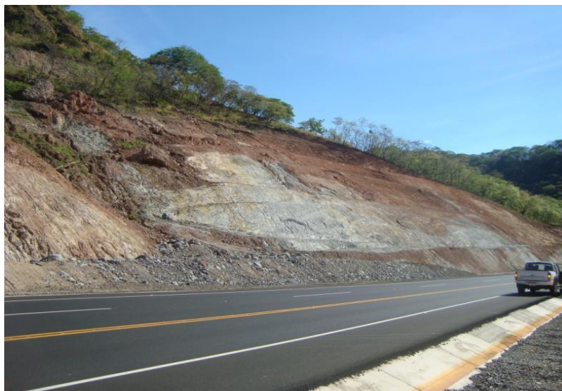
Grandes bloques de roca con condiciones precarias de estabilidad en un sector de la carretera, ubicado a unos trescientos de metros después de la zona donde se construye el viaducto para el ferrocarril. Nótese el efecto del hidrotermalismo en los taludes y bermas.
